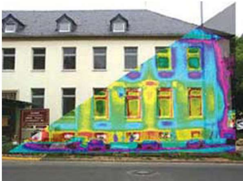
Рис. 1.32. Термографія частини будівлі показує коливання температури, вказуючи, де передача тепла назовні найбільш інтенсивна. Вікна є основною зоною передачі тепла назовні будинку
